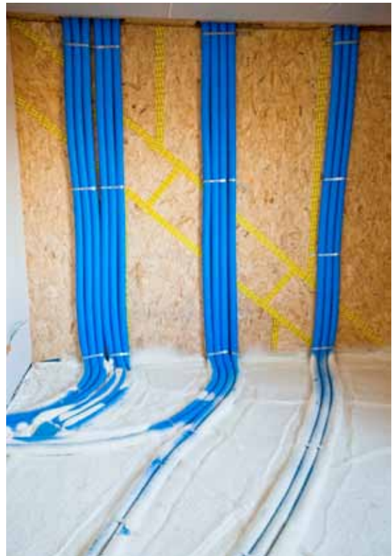
Ventilatieleidingen weggewerkt in de isolatie
