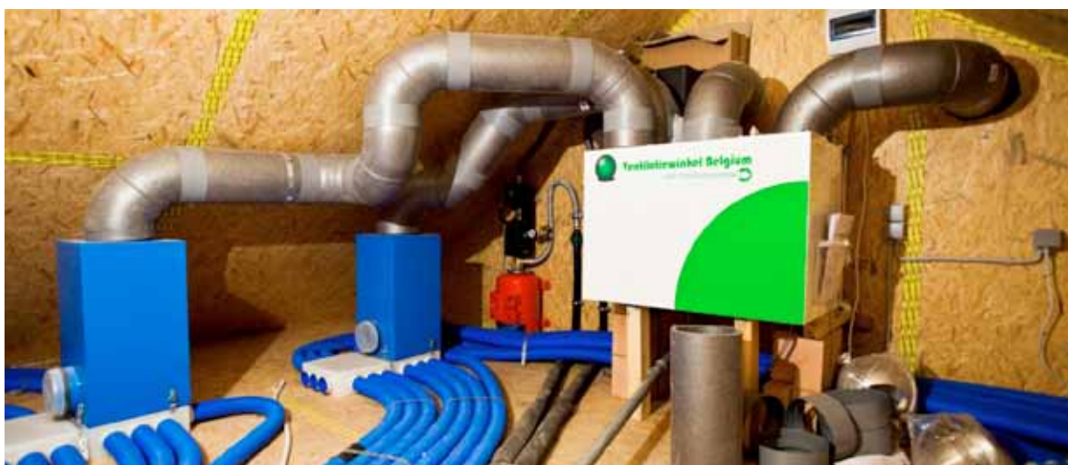
Ventilatiesysteem D met warmterecuperatie
